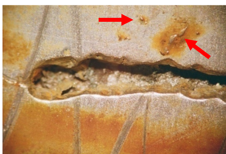
Figura 11. Aspecto de grieta vertical. Se señala salpicaduras de la soldadura (16X).
