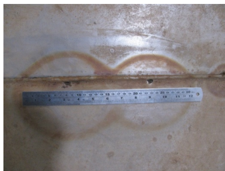
Figura 7. Picaduras sobre plancha del piso.
