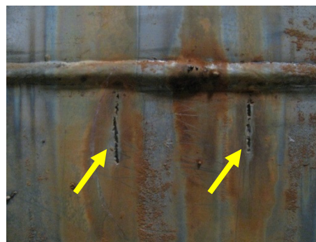
Figura 4. Picaduras sobre las paredes verticales del tanque.
