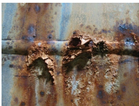
Figura 3. Productos de corrosión en cordón de soldadura.
