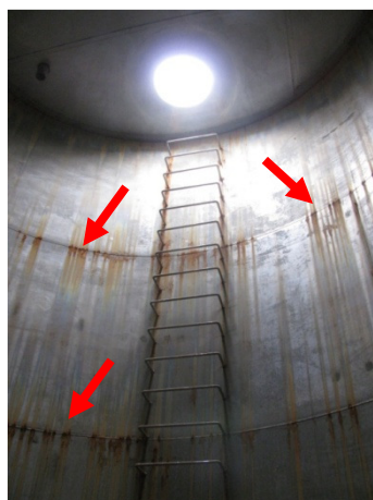
Figura 2. Interior del tanque, se indican productos de corrosión.
